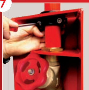
Mise en place du collier de maintien du dévidoir
